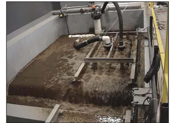
Quechan's membrane module in air scour mode.
